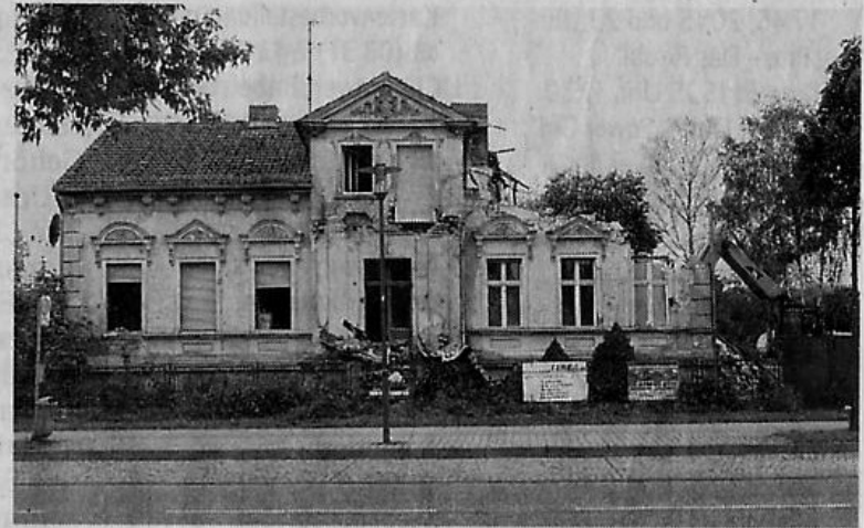
Stein des Anstoßes: der Abriss des denkmalgeschützten Hauses Dorfaue 20 in Großbeeren.
